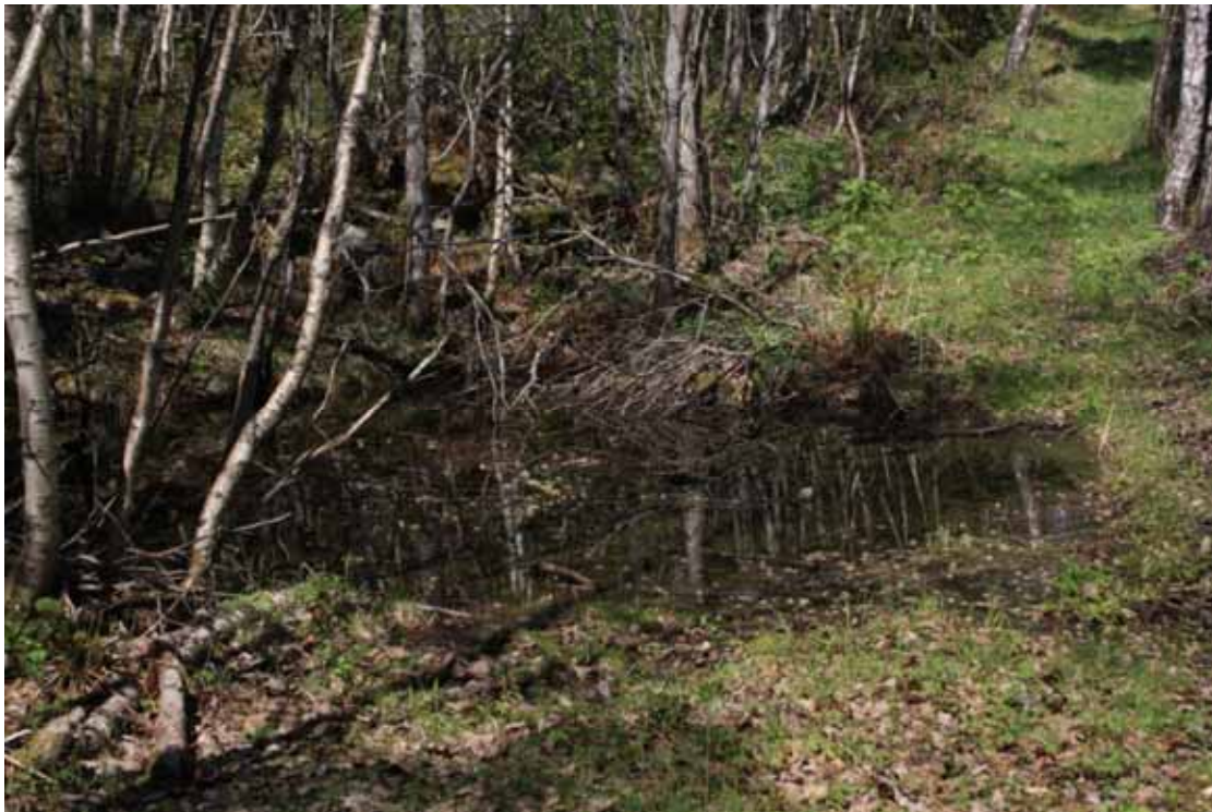
Figur 80. På vegen frå Nerre Dalen til Varpe bru har fleire av stikkrennene kollapsa. Foto: Katharina Sparstad
