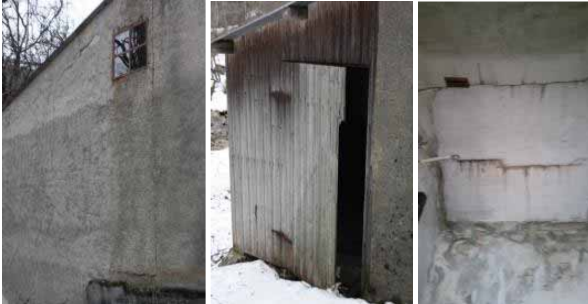
Figur 176. Huset har ein del skader. Frå venstre, sørsida har sprekkar i muren, og avskaling av murpuss. Bilete i midten: Til bygget er det ein utedo. Bilete til høgre: Taklekasje- Foto: Katharina Sparstad
