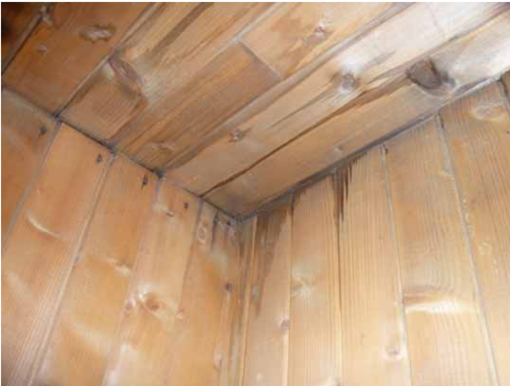
Figur 256. I tilbygget og overgang mellom nytt og gammalt er det taklekkasjar og røteskadar. Foto: Katharina Sparstad
