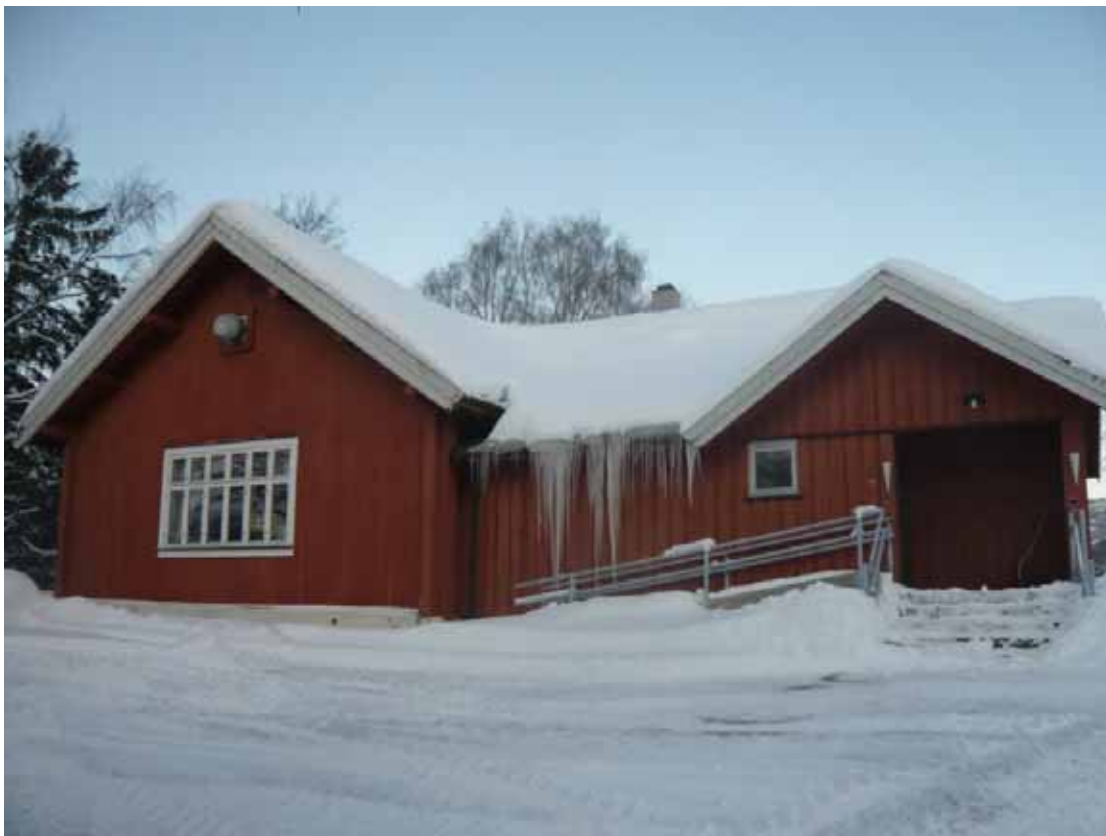
Figur 250. Torsheim i 2017. Dårlig isolasjon gjev smelting, istappar og vasslekkasje slik at huset no er dårleg eigna som forsamlingslokale. Foto: Katharina Sparstad
