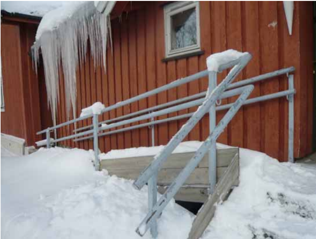
Figur 255. Mellombygget er av nyare dato og har dårleg isolasjon i taket. Foto: Katharina Sparstad
