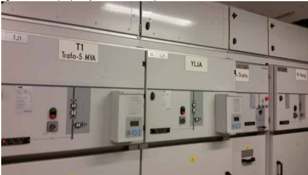
Figur 183. Transformator skåpa. Foto: Katharina Sparstad
