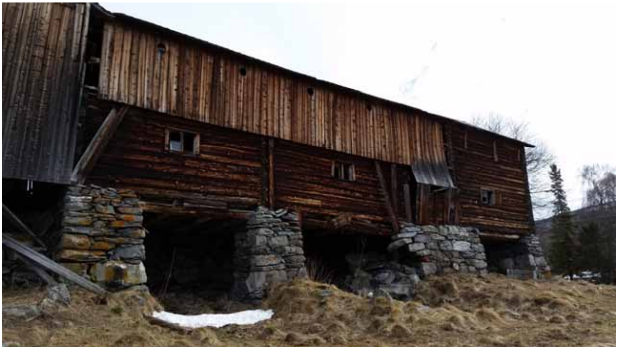
Figur 242. Det er mektige pilarar av stein under fjøset mot vegen. Biletet syner at delar av muren har glide ut. Foto: Katharina Sparstad
