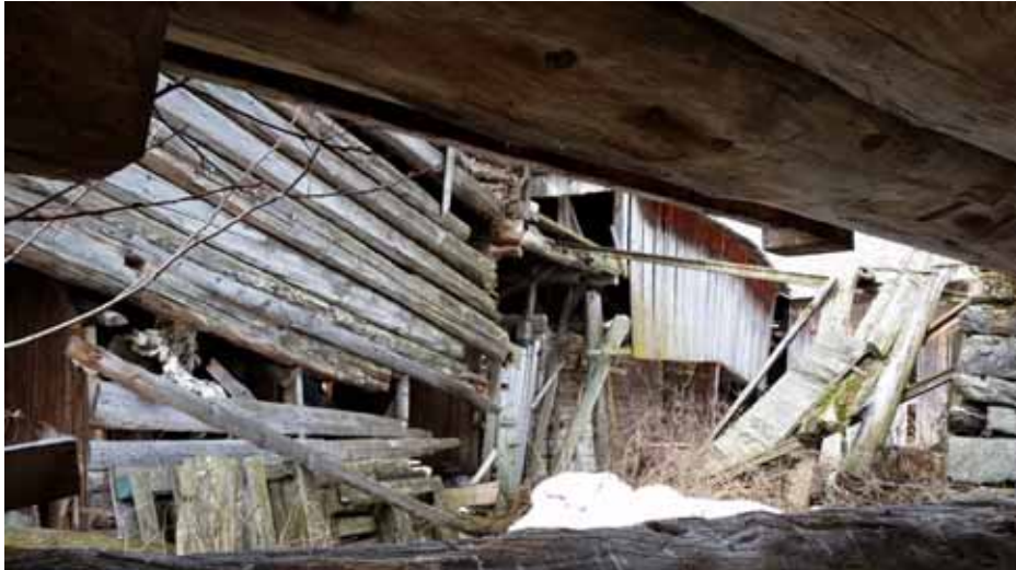
Figur 239. Låven er i svært dårleg forfatning, og bruk utgjer ein risiko. Foto: Katharina Sparstad
