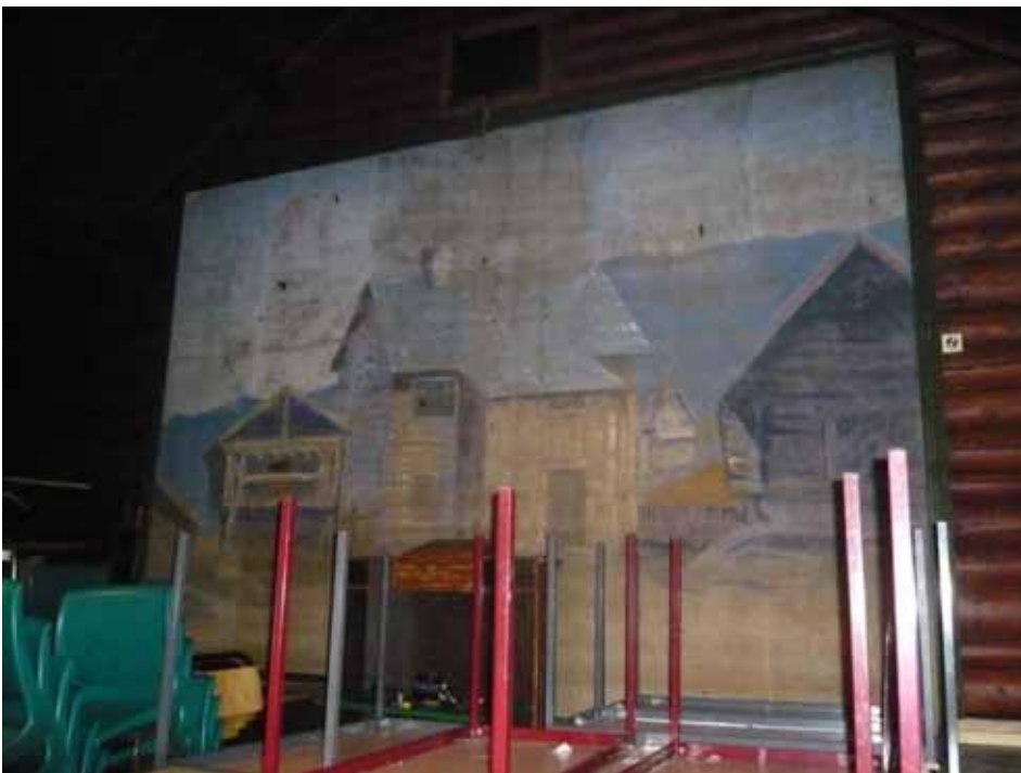
Figur 252. Vegglerretet er noko vass-skada. Foto: Katharina Sparstad
